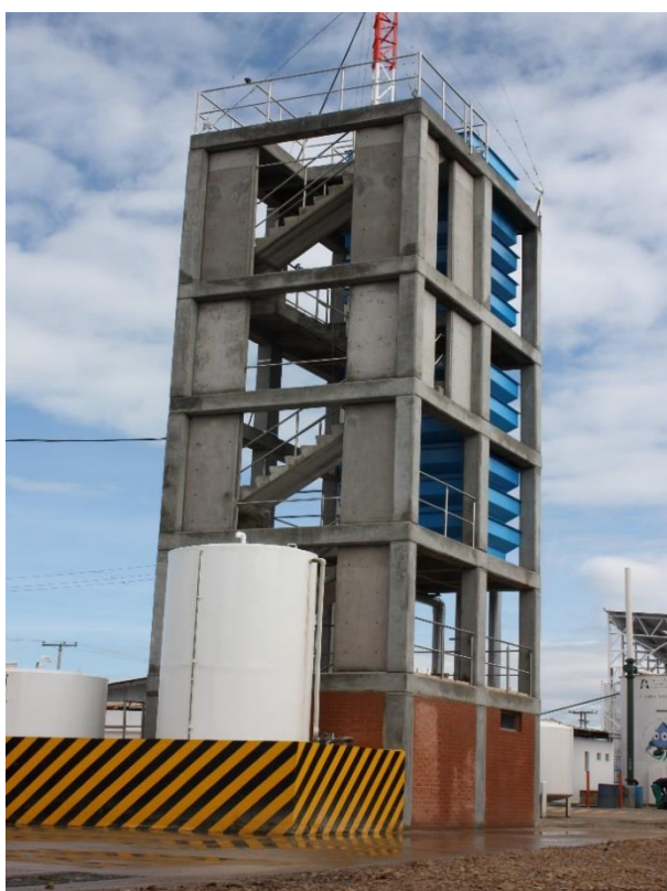
Torre de Aireación para Pozo Uno y Pozo dos Planta Principal
