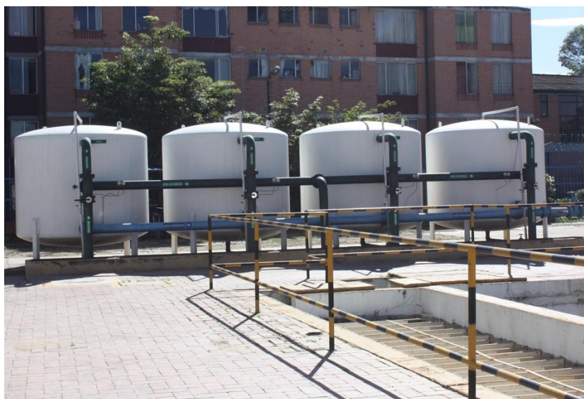
Batería Filtros Planta Principal
